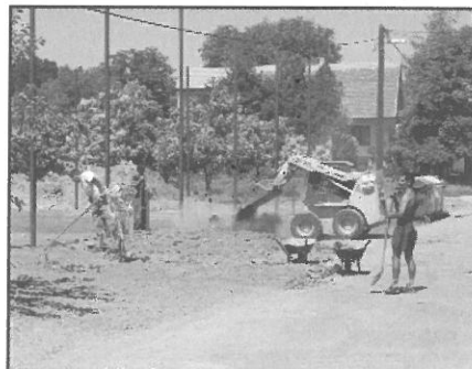
A Lőcsei utcai sportpálya és játszótér. A munkások a sportpálya melletti terepet rendezik
