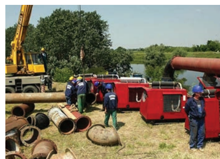
7. kép. Nagyteljesítményű mobil aggregátoros szivattyútelep
