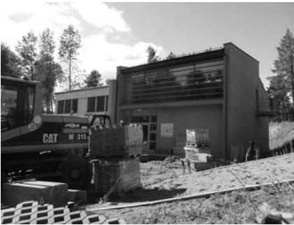
A fromborki csillagászati park főépülete. A felvétel munkaszüneti napon készült. A munkagépeket és az építési anyagokat jól láthatóan nem őrizte senki
