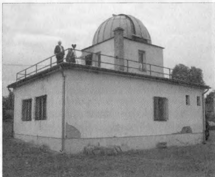
A csillagda épülete mára igencsak megérett a felújításra
