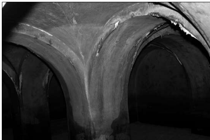
12. kép: Boltozatos földalatti helyiség a kürtő alatt, amely egykor – öt társával együtt – víztároló, illetve szűrő komplexumként működött Fig. 12: Vaulted underground room discovered under the funnel, once used – with five others – as a water-storage and filtration complex; Ybl Miklós tér, middle part
